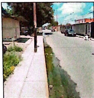
Colapso en la Av 05
