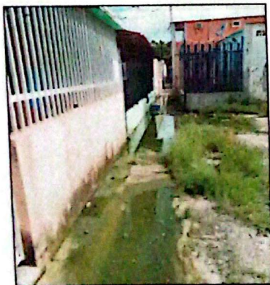
Colapso en la vereda
