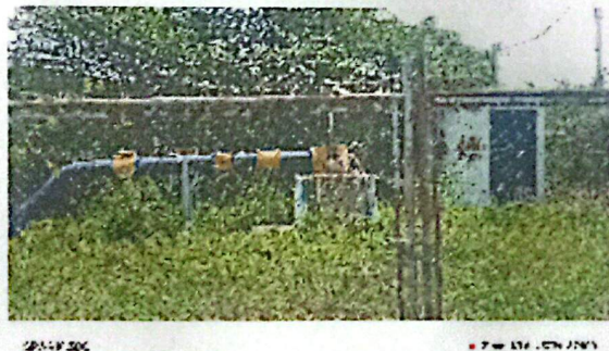
Pozo 7. Sector Titicare. UNICO ABASTECIMIENTO para la comunidad de TITICARE
