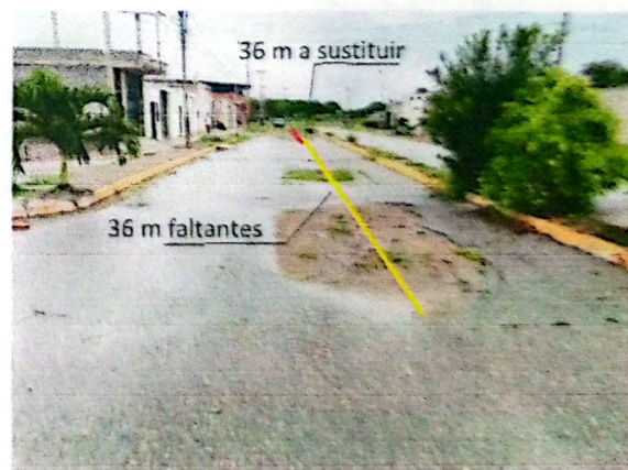
Foto 2. Tramo total afectado (72 m acero 16 plg)
